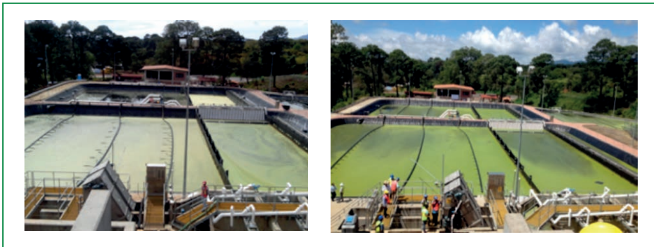
FIGURA 5.2.8. Planta de tratamiento de aguas residuales San Antonio, en Uruapan, Michoacán
